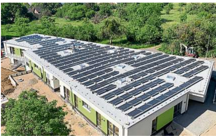
Die Kita ist an das Fernwärmenetz der Klinik angeschlossen, Strom wird über eine Fotovoltaik-Anlage auf dem Dach produziert. Fotos: Pieck
